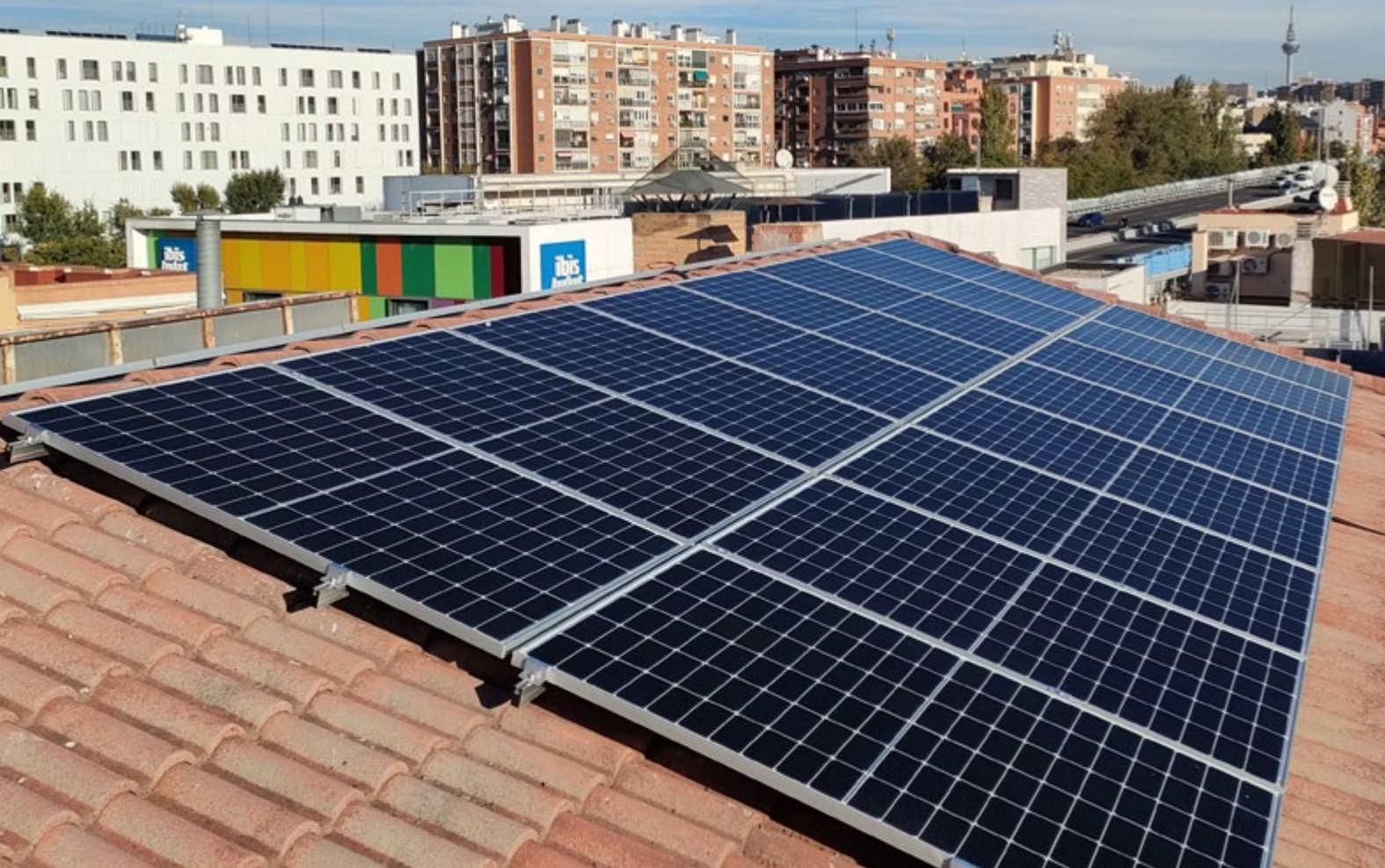
Instalación solar en el tejado de la sede de SEO/BirdLife en Madrid. / ©Sergio Galeano
